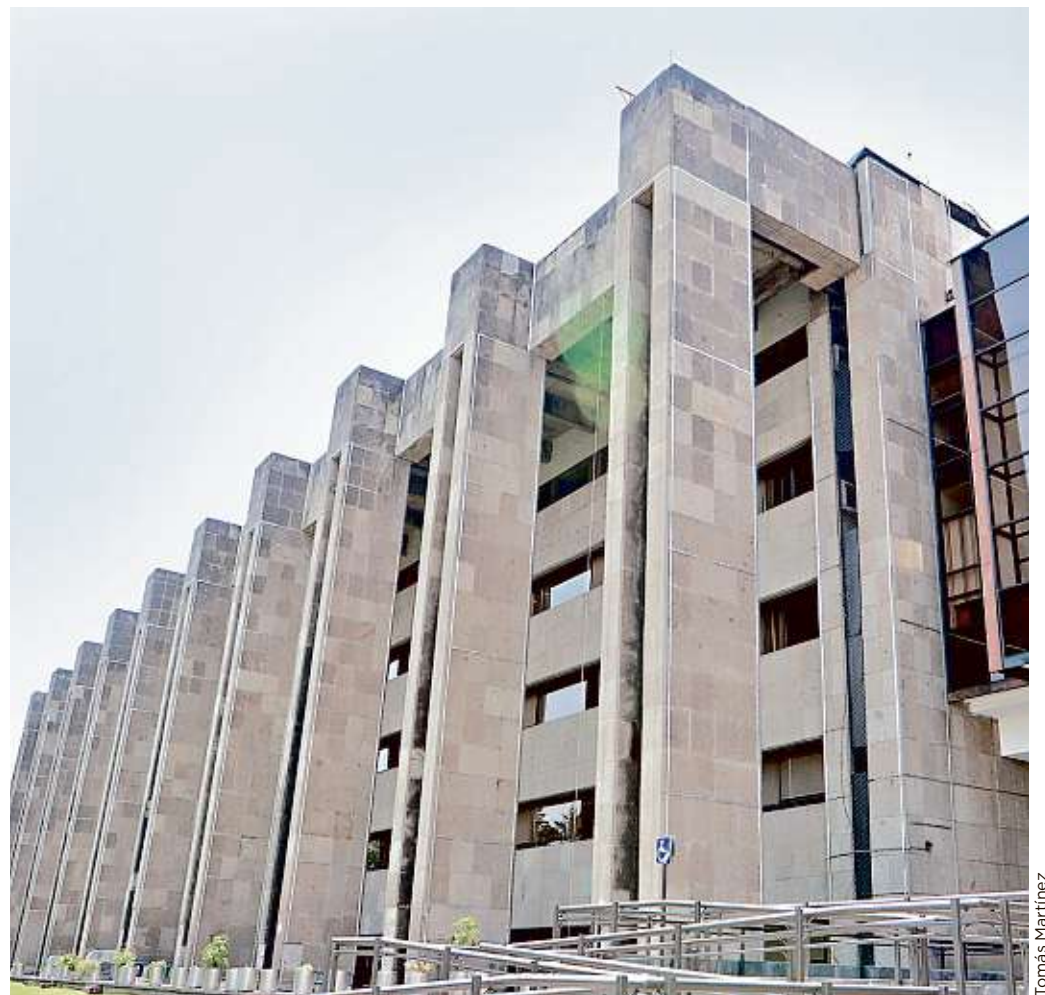
Las fachadas de los edificios de la Cámara de Diputados muestran deterioro ante las fallas registradas en un proyecto de reparación realizado en 2013.
