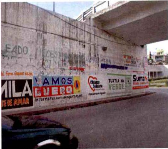
Calle central y libramiento norte (Paredes debajo del puente)
