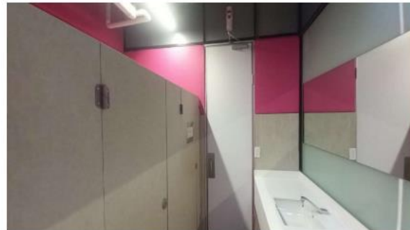
ACABADOS EN PISOS Y MUROS CON LOSETA CERAMICA Y PINTURA VINILICA, INSTALACIÓN DE CUBIERTAS, MAMPARAS Y PUERTAS DE SOLIDO FENOLICO FENOTECK. INSTALACIÓN DE MUEBLES Y ACCESORIOS SANITARIOS
