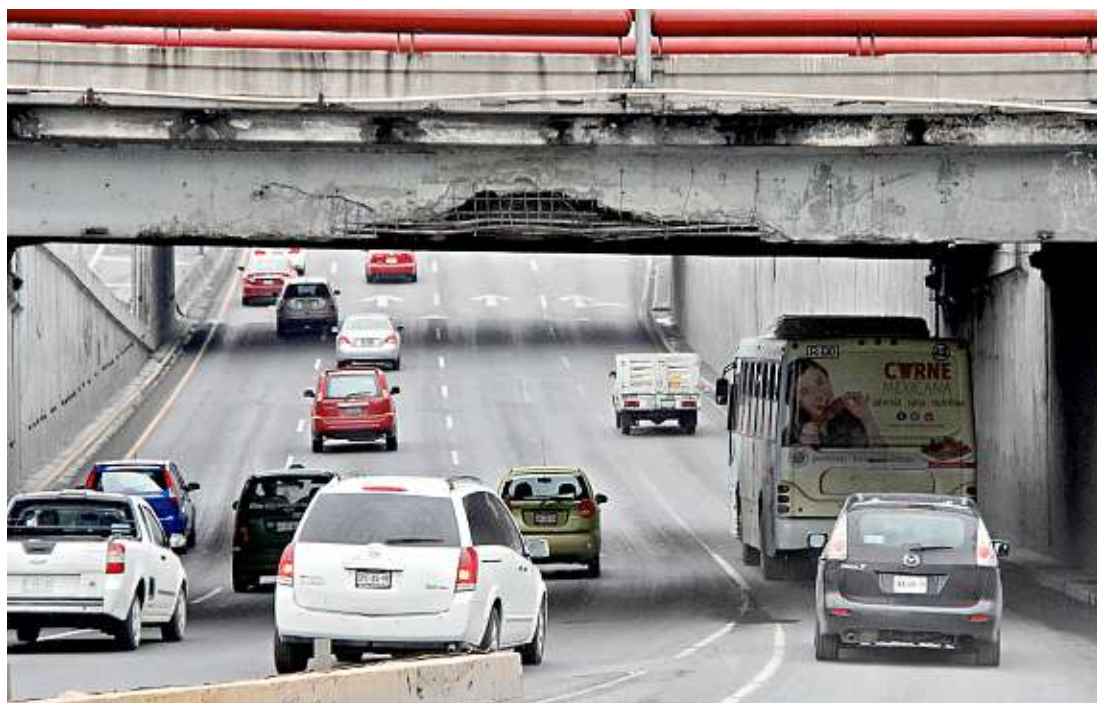
El Puente Cuauhtémoc presenta desprendimientos de concreto que representan un riesgo para quienes circulan por Constitución.
