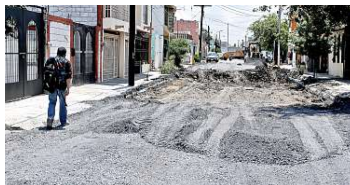
Los hundimientos volvieron a formarse en la calle Lisino apenas un mes después de que el municipio concluyó el recarpeteo.
