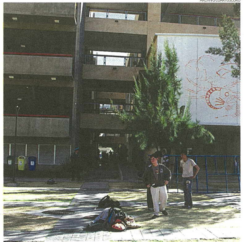
DETERIORO. Las instalaciones de la UACM lucen maltratadas pese a la inversión.
