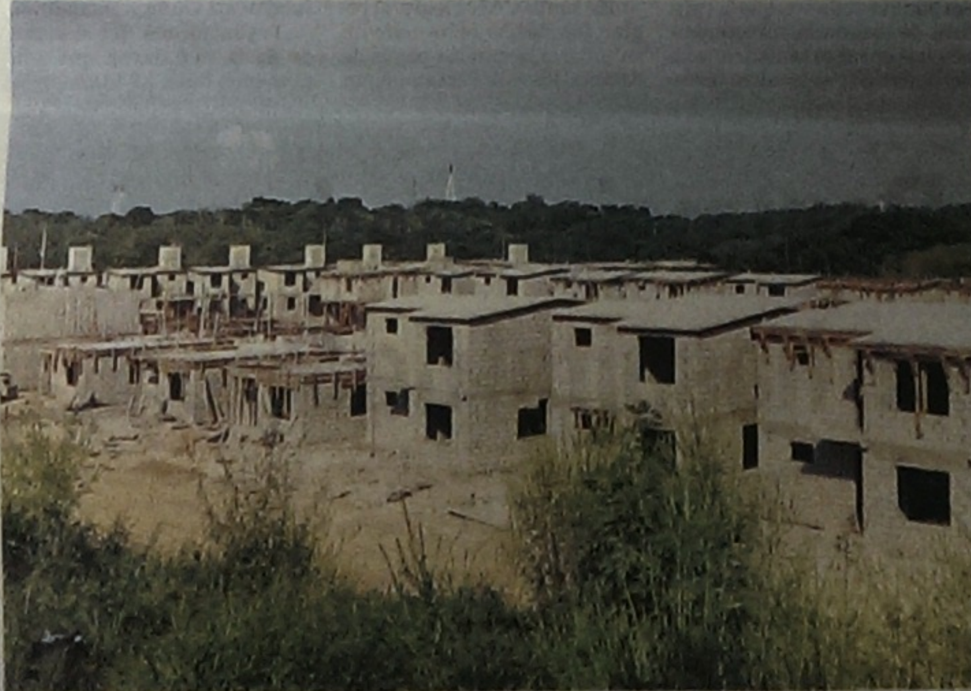
ESTAS SON ALGUNAS DE LAS 300 VIVIENDAS que se han edificado en el fraccionamiento residencial Sección 11.
