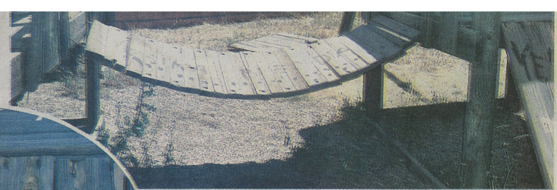
>>UNO de los puentecitos ya comenzó a caerse, las tablas que lo componían se ven ladeadas y las cuerdas que lo sostenían ya no están.
