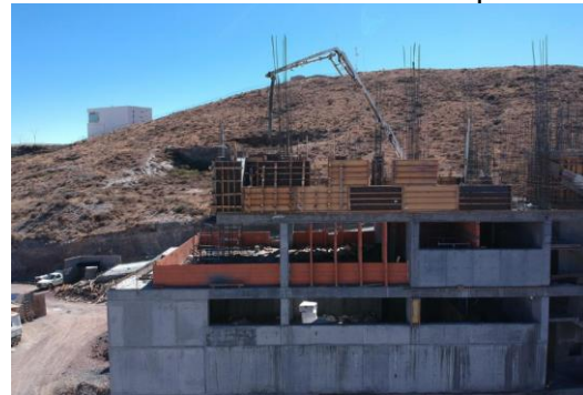
Armados y colados de elementos estructurales, tales como losas, muros y columnas de segundo y tercer nivel
