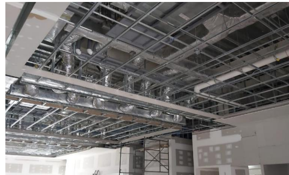
Instalaciones mecánicas y especiales
